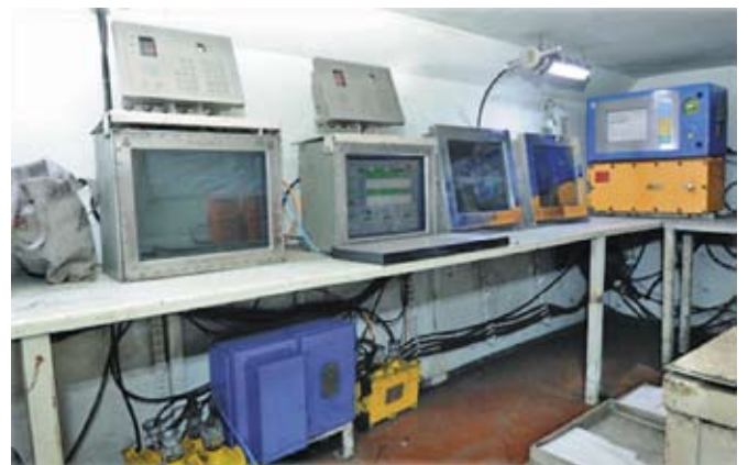
Рис. 4. Центральный подземный пульт управления.
