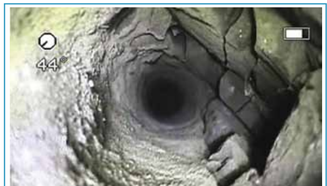
Рис. 2. Пример нарушений левого борта взрывоустойчивой перемычки № 7416 на глубине 1,0 м в шпуре № 4 Fig. 2. Example of the explosion-proof dam No. 7416 left side distortion at a depth of 1.0 m in hole No. 4
