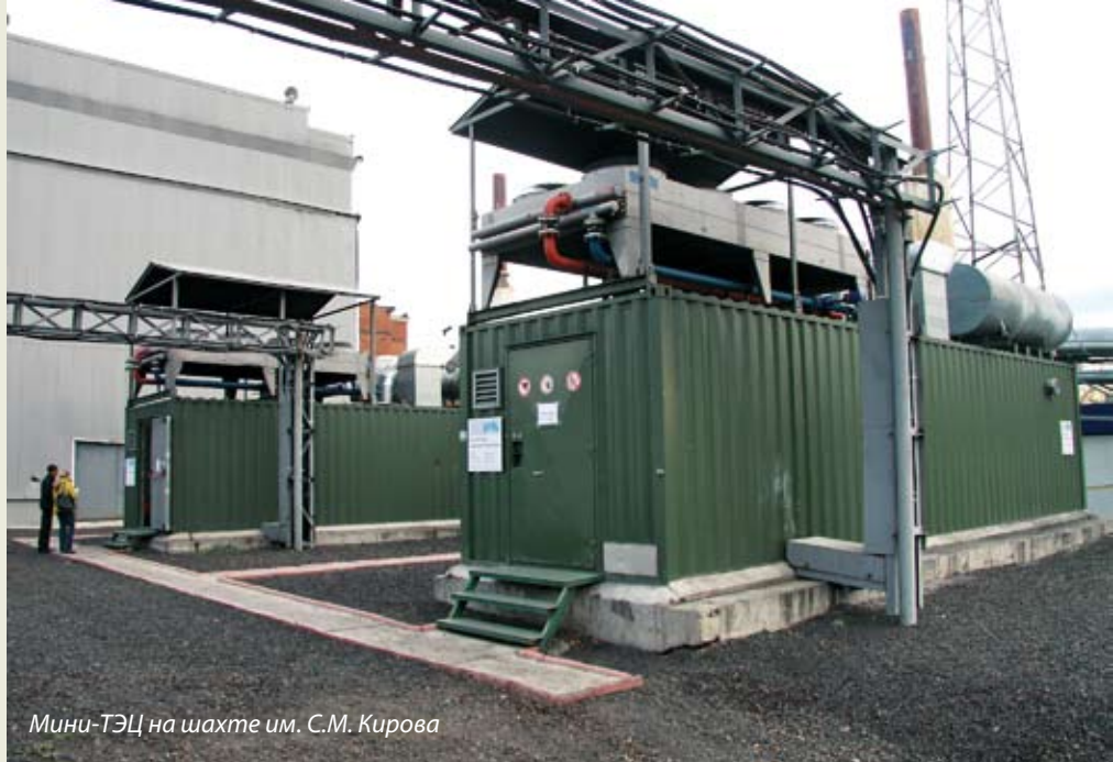
Вакуум — насосная станция на шахте им. С. М. Кирова
