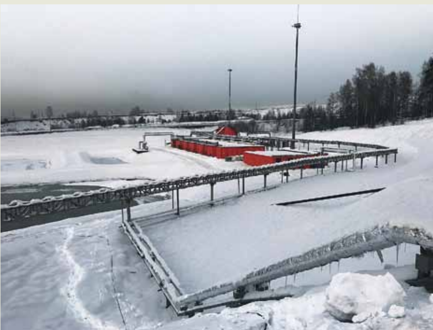
Рис. 8. Шахта «Талдинская-Западная – 1». Очистные сооружения шахтных вод и хозяйственно-бытовых стоков
