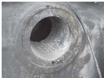
Исходное состояние отверстий редуктора
