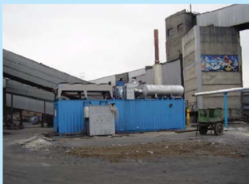
КТЭС 1,35 мВт, шахта 22 Коммунарская, Донбасс
