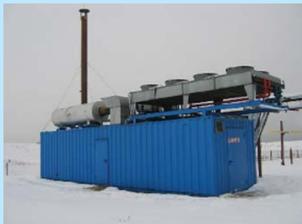
КТЭС 1 мВт, шахта им. Кирова, Кузбасс
