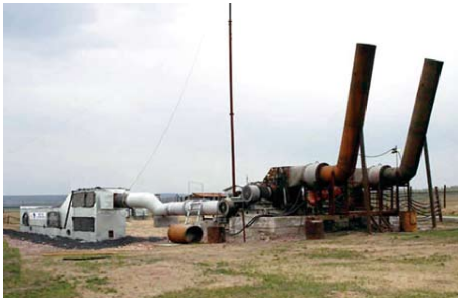
Рис. 2. Система взрывозащиты на дегазационной площадке
