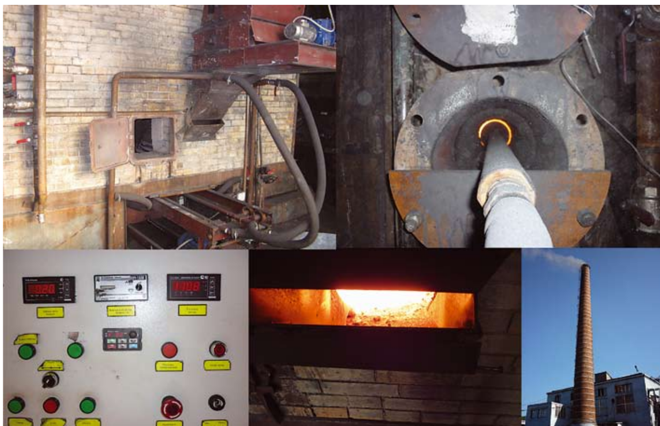
Котельная, котел ДКВЗ-10-13, работающий на ВУТ
