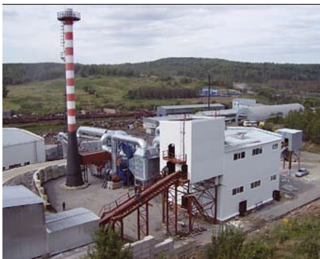
Энергокомплекс МТЭУ-ВНУ 075x2 (15,0 МВт) шахты «Талдинская-Западная-1»
