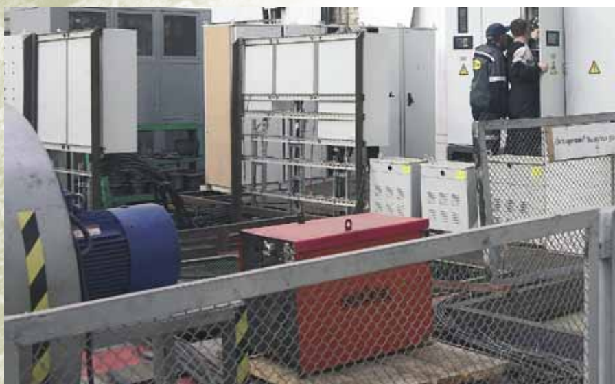
Станция для испытания двигателей
