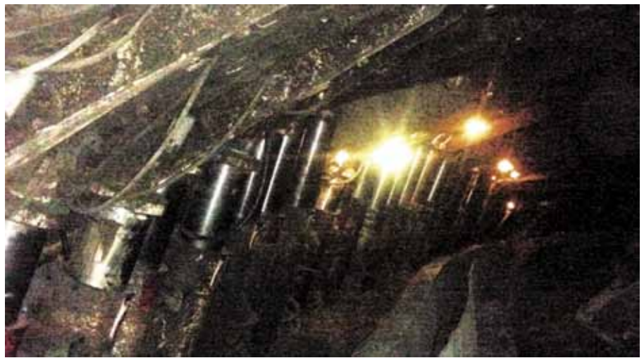
Рис. 3. Действующая эксплуатация СМК: СМК наклонены на забой, поддерживающие и ограждающие элементы находятся на одной линии или в одной плоскости, поддерживающая способность утрачена (отсутствует)
