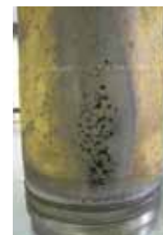
В систему охлаждения была залита универсальная охлаждающая жидкость — отчетливо видны разрушения гильзы, вызванные кавитацией
