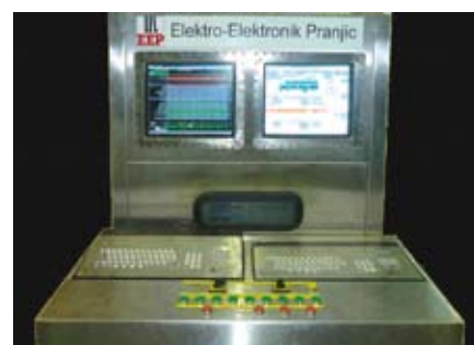
Подземный пульт управления
