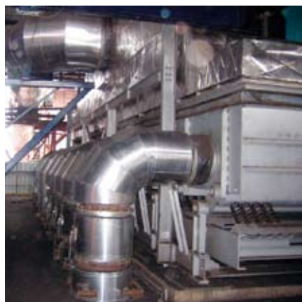
Рис. 7. Подвод горячих газов к сушилке «виброкипящего» слоя [4]
