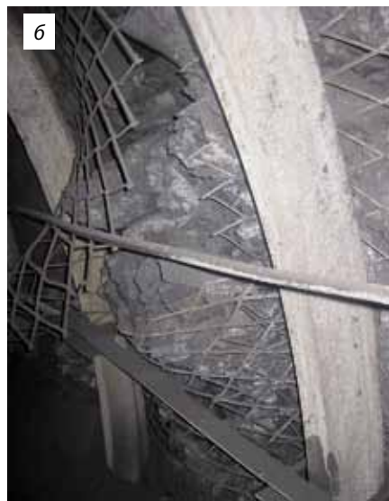
Рис. 1. Состояние конвейерного промежуточного штрека 50к 10-3 шахты «Абайская» Карагандинского угольного бассейна в зоне влияния очистных работ:
