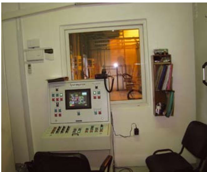
Рис. 2. Пульт оператора котла водогрейного KBm-2,5-K-95(115)
