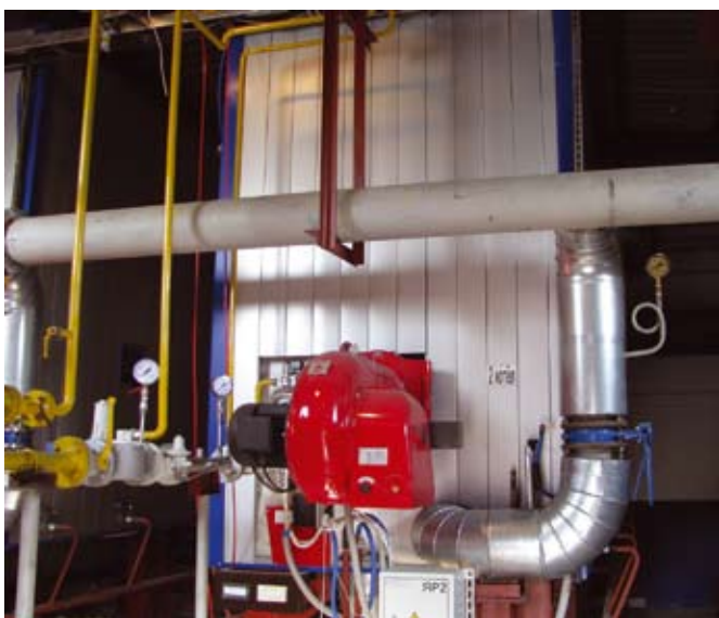
Рис. 3. Котел водогрейный KBa-2,5-Гс-95(115)
