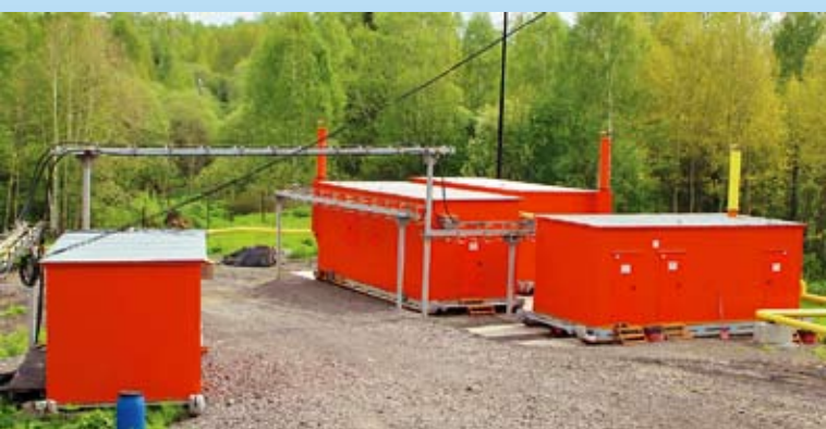
Установка ООО «НПП «Завод МДУ» на шахте «Кушеяковская»
