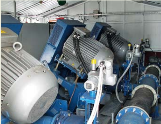
Рис. 4. Общий вид насосных агрегатов
