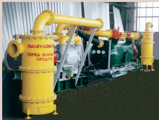
На шахте «Краснолиманская» в составе подземных дегазационных узлов эксплуатируется 16 шт.
