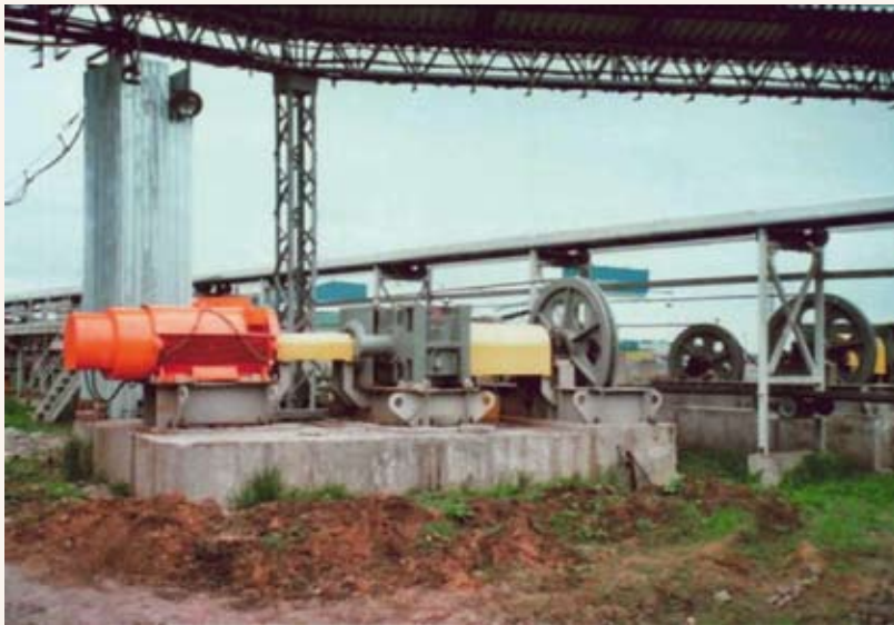
Приводная станция одноставного канатно-ленточного конвейера
