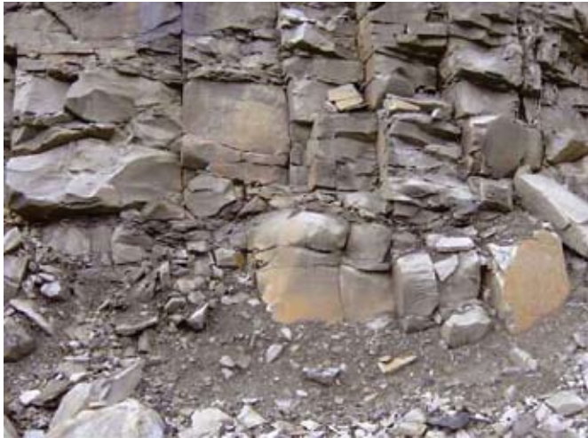
Рис. 2. Трещиноватость пород кровли пласта K_4 Денисовского месторождения
