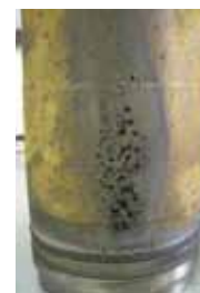
В систему охлаждения была залита универсальная охлаждающая жидкость — отчетливо видны разрушения гильзы, вызванные кавитацией
