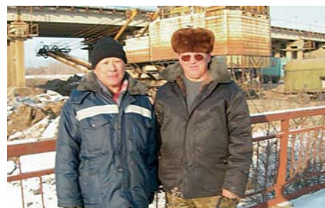
Заместитель директора РУ «Лучегорское» по производству Александр Викторович Супрун (на фото справа) и начальник дорожно-эксплуатационного участка Ким Бу Ги в ответственный момент перегона экскаватора под железнодорожным путепроводом
