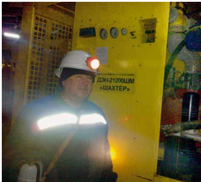
Компрессорная установка ДЭН-21200ШМ «ШАХТЕР», рудник «Айхал»
