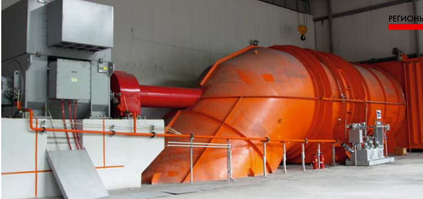
Вентилятор главного проветривания — единственный в России агрегат, который благодаря техническим характеристикам заменяет сегодня работу двух прежних вентиляционных установок
