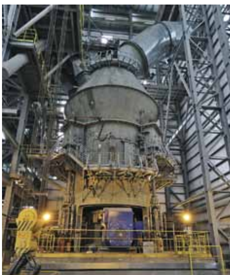
TOTAL AZOLLA ZS 46 обеспечивает работу всех гидравлических систем цементной мельницы
