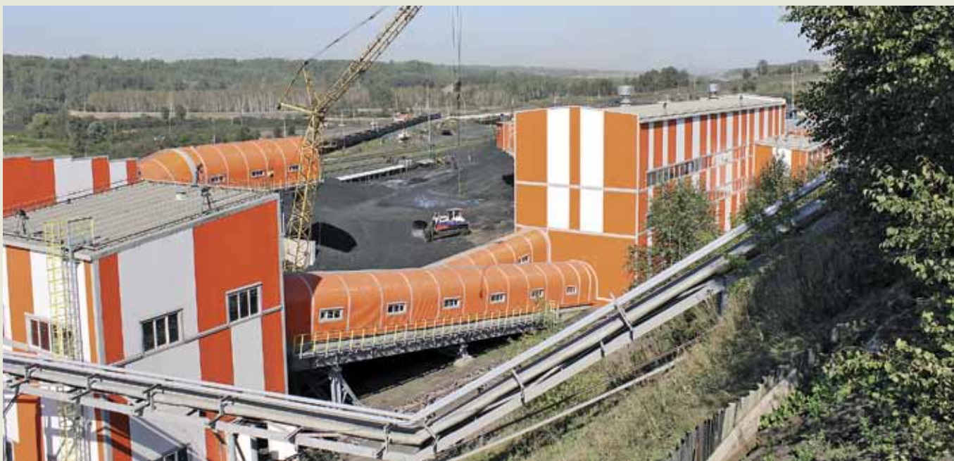
Обогатительный модуль на шахте «Талдинская-Западная №1» мощностью по переработке 2,7 млн т в год
