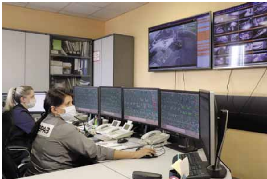
Рис. 5. Операторы пульта управления круглосуточно контролируют производство на ОФ «Распадская»
