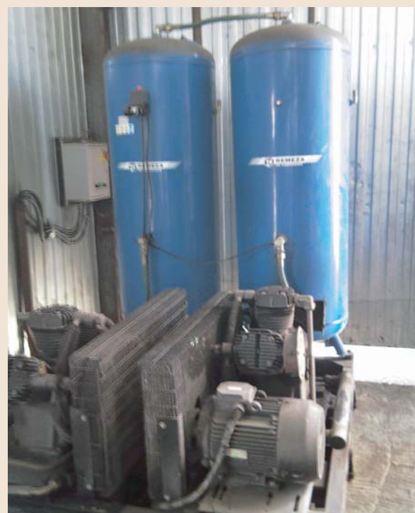
Рис. 1. Общий вид установки по приготовлению водоугольного топлива
