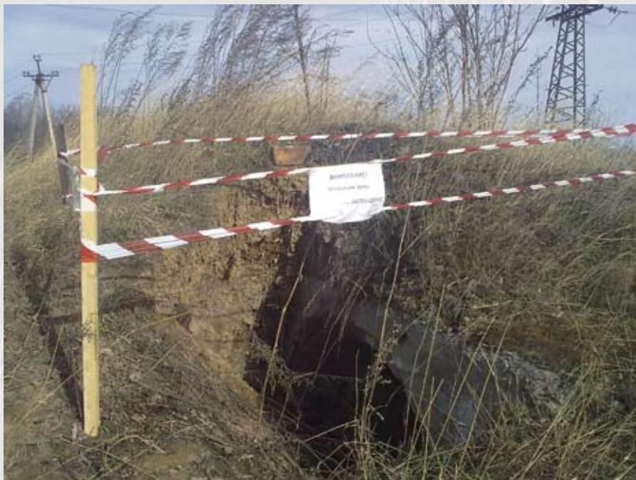
Рис. 2. Провал на горном отводе ликвидируемой шахты «Кольчугинская» над воздухоподающей сбойкой
