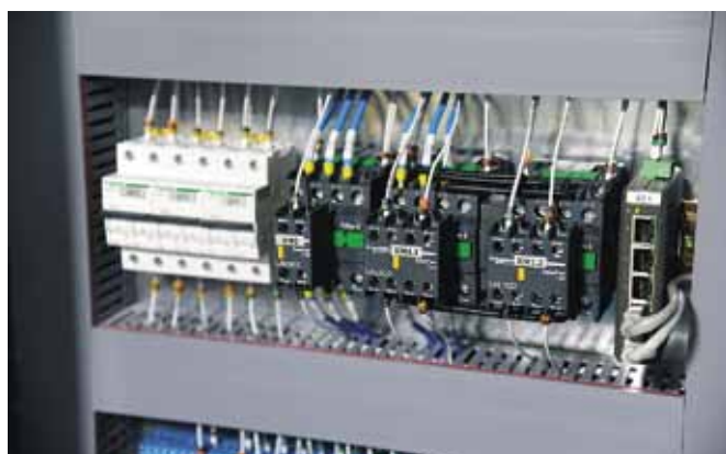
Рис. 2. Фрагмент шкафа управления
