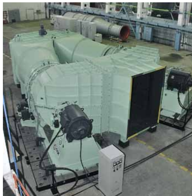
Рис. 1. Установка главного проветривания типа АВМ с САУ
