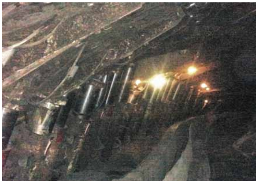
Рис. 4. Разворот поддерживающих элементов в традиционной секции механизированной крепи поддерживающе-ограждающего типа при смещении равнодействующей от опорного давления в сторону завала
