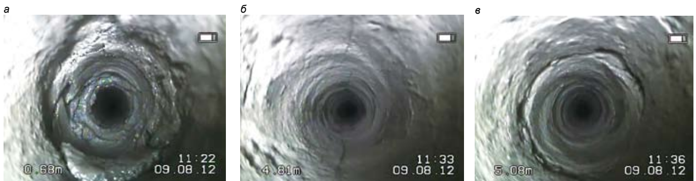
Рис. 2. Фактическое состояние пород кровли конвейерного штрека №42 шахты «Березовская» на глубине: а — 0,07 м; б — 4,6–4,8 м; в — 4,9–5,1 м
