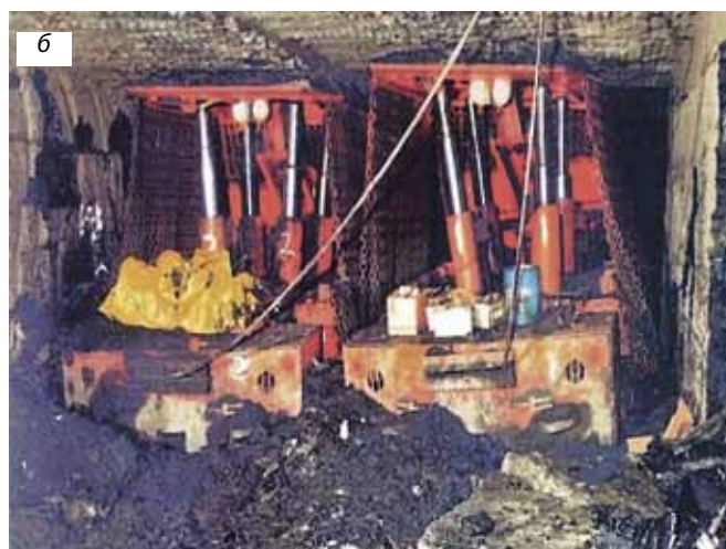
Рис. 4. Общий вид самоходной американской крепи MRS (а) и размещение крепей в выработке (б)
