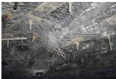
Проявления горного давления в присечных выработках: а – деформации в виде прогибов кровли горной выработки, закрепленной одноуровневой анкерной крепью; б – куполообразование в кровле выработки при комбинированной крепи выработки
