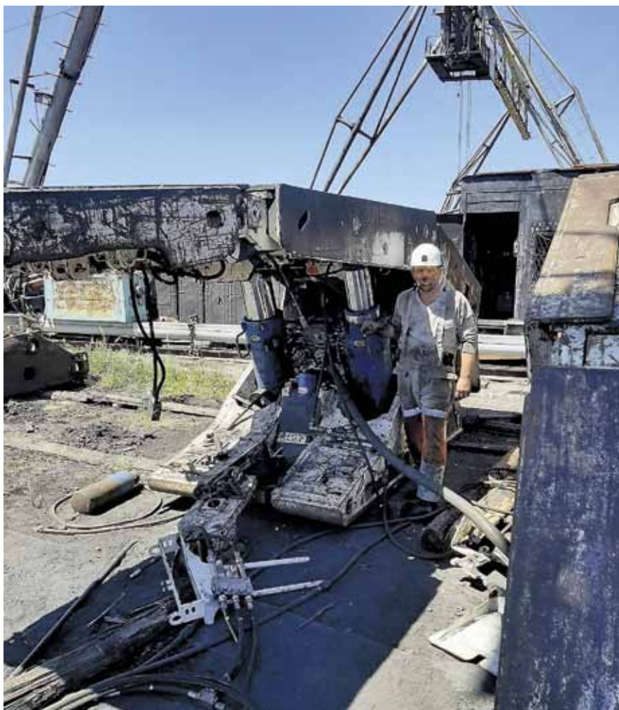
Выявление замечаний разработчиком в процессе перемонтажа секций с шахты «Абайская» на шахту «им. Ленина»
