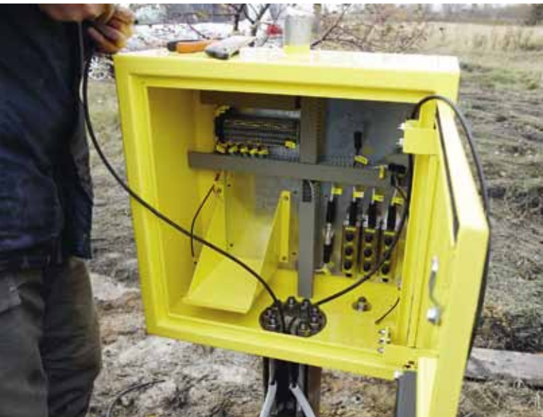
Система контроля устойчивости бортов разреза предупредит о глубинных смещениях в массиве горных пород задолго до появления признаков деформаций на поверхности борта
