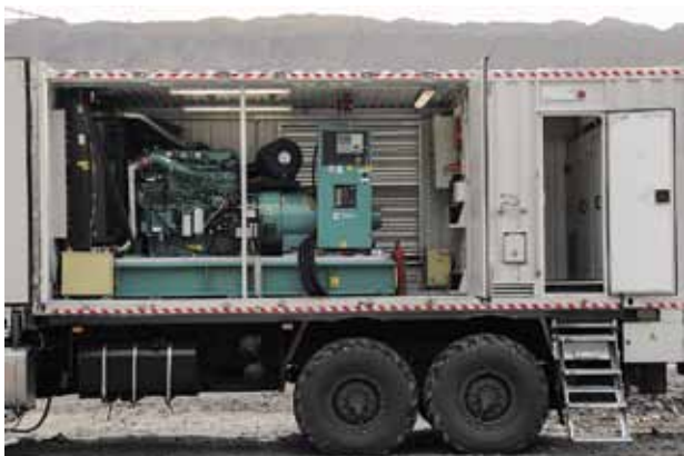
На мобильном перегоне установлена мощная энергосиловая установка
