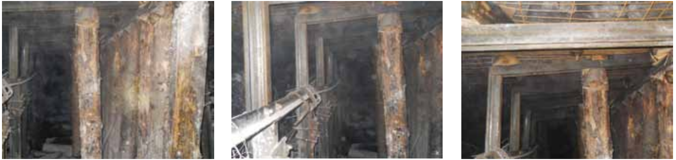
Рис. 4. Состояние сохраняемой части вентиляционного штрека № 26-25 бис
