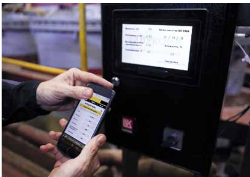
Онлайн-мониторинг масла на стационарном турбинном оборудовании Конаковской ГРЭС (ПАО «ЭЛ5-Энерго»)
