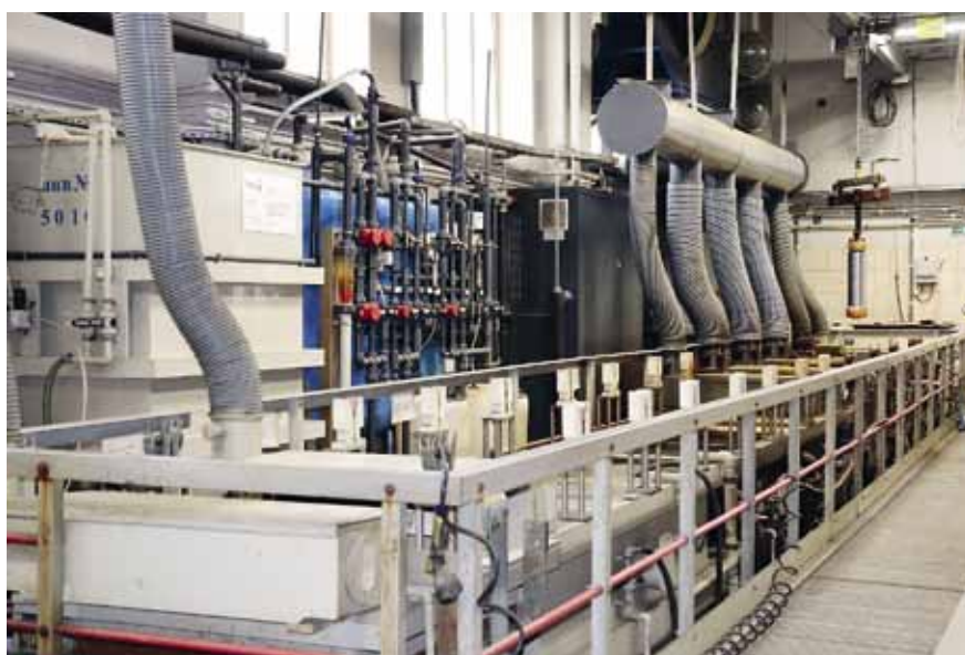
Рис. 4. Линия нанесения гальванического покрытия Voving
