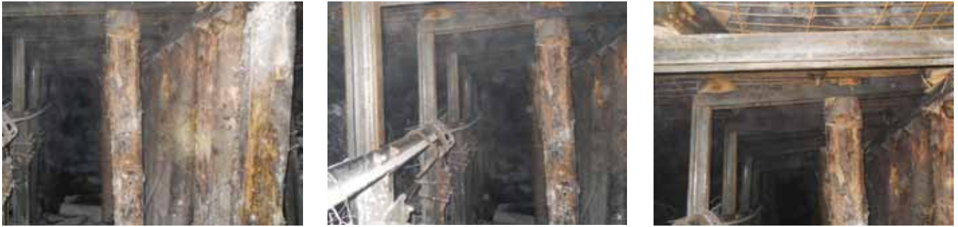
Рис. 4. Состояние сохраняемой части вентиляционного штрека № 26-25 бис
