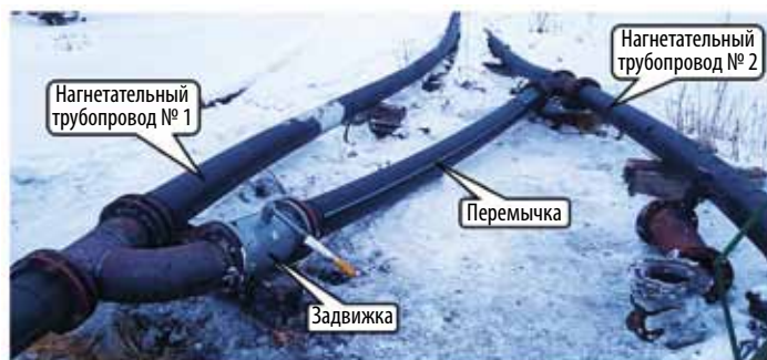
Рис. 7. Параллельное соединение нагнетательных трубопроводов ГВУ
