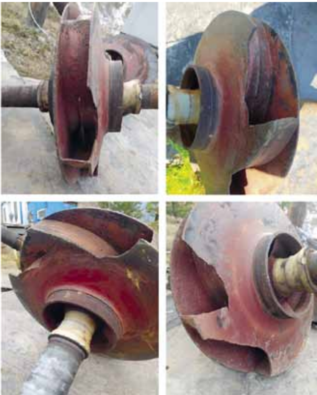
Рис. 1. Разрушенные колеса насосов ГВУ
