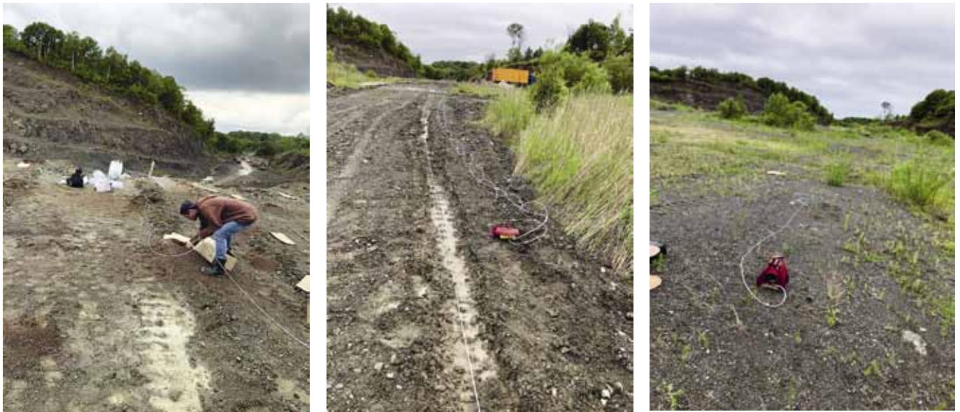
Рис. 8. Монтаж коаксиального кабеля от скважин до приборов в открытиях: а – от скважин; б – к ИВИ-4; в – к VOD305
